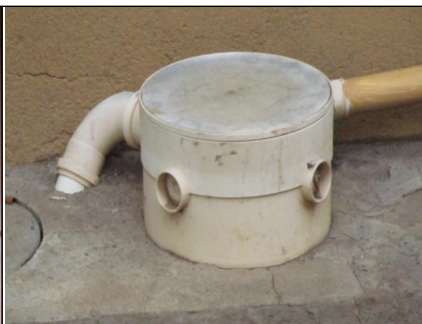
FOTO 02 – Caixa de Gordura
